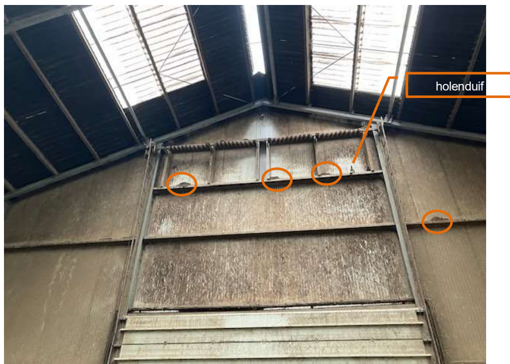
• Afbeelding 22: sporen van duiven in de kopgevel van stal 3
